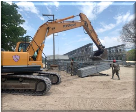
Apoyo al desarrollo con carreteras de tercer orden, colocación de puentes, perforación de pozos, entre otros
